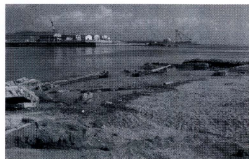
破壊された地御前五丁目護岸
